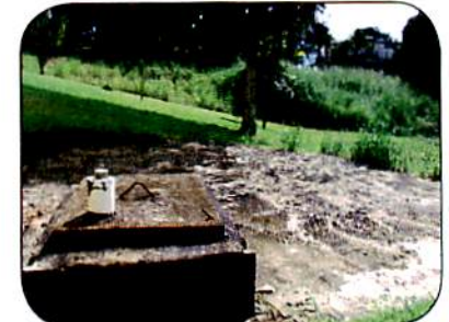
Mantenga el pozo séptico sellado.
