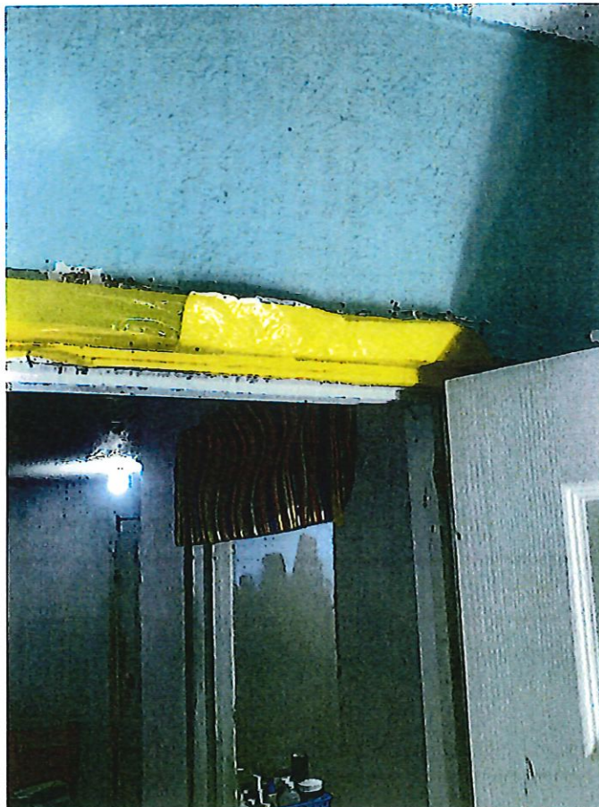
Damaged Drywall above Door Frame
