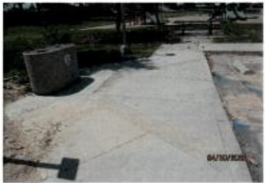
ADA Ramp (Before)
