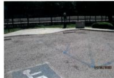
ADA Ramp (Before)
