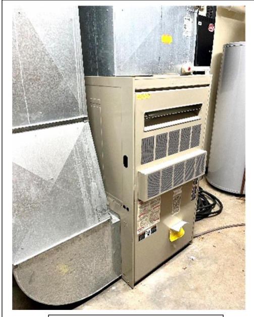
Indoor AC Unit
